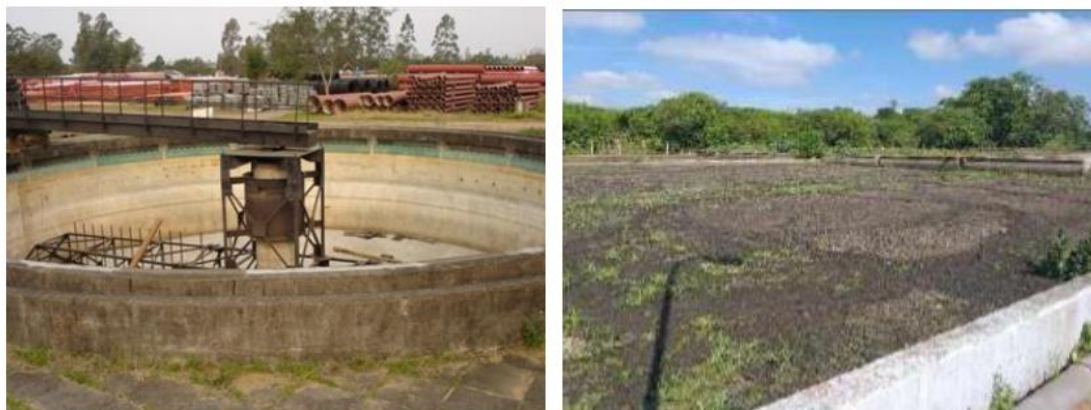
Figura 25 – Unidades do Tratamento de Lodo da ETE Mato Grande – Adensador de lodo/tanque para armazenamento de lixiviado (à esquerda) e Leito de Secagem de Lodo (à direita).
