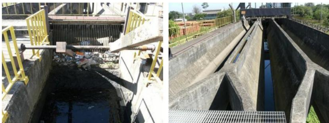
Figura 22 – Unidades do Tratamento Preliminar da ETE Mato Grande – Gradeamento (à esquerda) e Desarenador (à direita).
